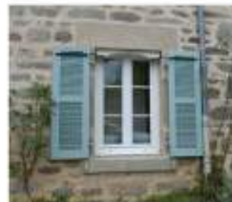
Volets battants électriques (Peyrat le Château, 87)
