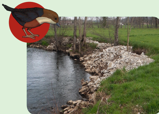
Encoche d'érosion : type de remblais à proscrire
